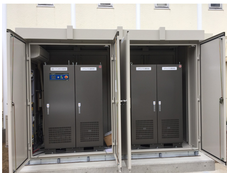
<PV 連係リチウムイオン蓄電システム
